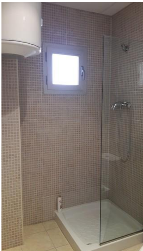
El plat de dutxa dels serveis de la sala de descans del CEEI-3
